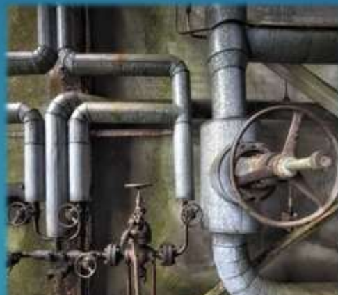
Трубы водопровода и отопления
